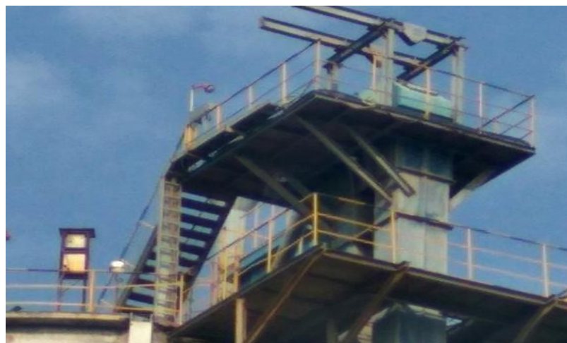
现有工程提升机除尘器
